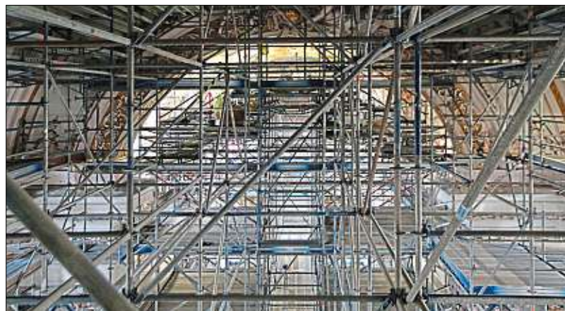
Die Arbeitsbühne der Restauratoren steht auf einem mächtigen Raumgerüst, das den gesamten Kirchenraum überspannt.
