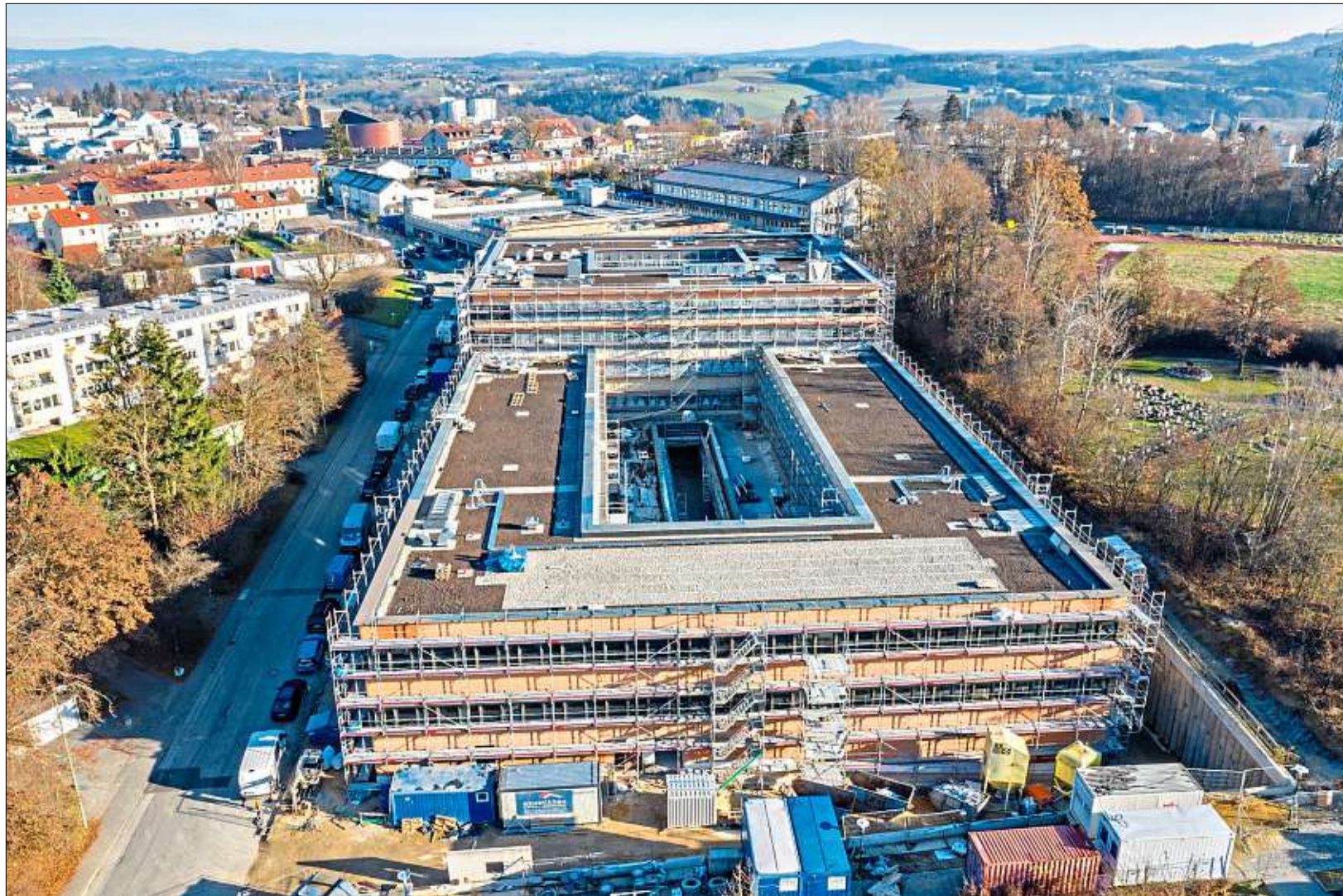
Der Neubau für die Landespolizei in Passau war im vergangenen Jahr die größte Hochbau-Baustelle des Staatlichen Bauamts Passau. – F.: red
