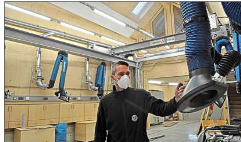
„Wir freuen uns schon alle“: Dombaumeister Jérôme Zahn prüft ein Absauggerät über einem Steinmetz-Arbeitsplatz.
