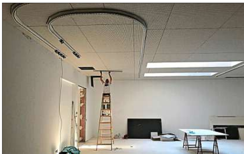
Der Multifunktionsraum wurde mit Schienen an der Decke ausgestattet. Hier können verschiedene Gegenstände eingehängt und eine bestimmte Kulisse geschaffen werden, um unterschiedliche Einsatzsituationen zu trainieren.
