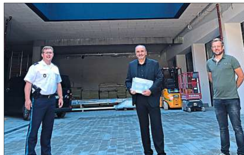
Freuen sich , dass die Polizeibaustelle trotz mancher Lieferschwierigkeiten noch im Zeitplan liegt: (v.l.) stv. Polizeichef Christian Dichtl, Leitender Baudirektor Norbert Sterl und Projektleiter Michael Knon vom Staatlichen Bauamt Passau.
