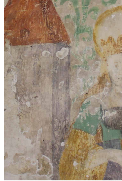
Abb. 93: Endzustand: Fragmentarisch erhaltene Wandmalerei mit abgeschlossener Randsicherung
