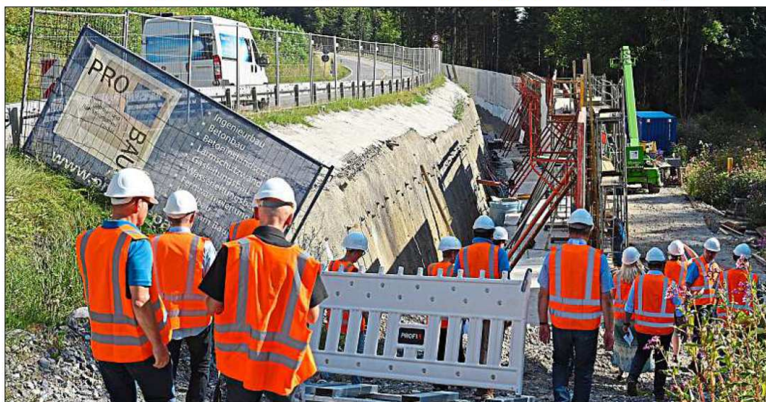
Deshalb gilt dort Tempo 30: Fast acht Meter in die Tiefe geht es unmittelbar neben der Bundesstraße.
