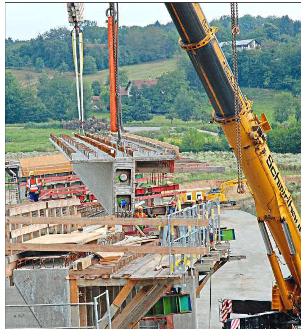
An nur zwei Haken hing der Plattenbalken. 34 Meter lang waren die ersten Teile, die das Brückenfeld über die Ortenburger Straße überspannen. Fünf solcher Brückenfelder gibt's.
