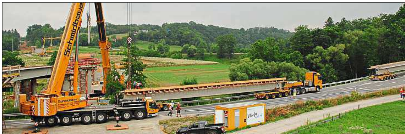
Mit Spezialfahrzeugen wurden die bis zu 100 Tonnen schweren Fertigteile von einem Ende der Stadt (Produktionsstätte Wieshof) zum anderen (kurz vor Zeitlarn) gefahren. Im Stundentakt wurden die Teile in das Brückenfeld gehoben. – Fotos: Niklas Grassl
