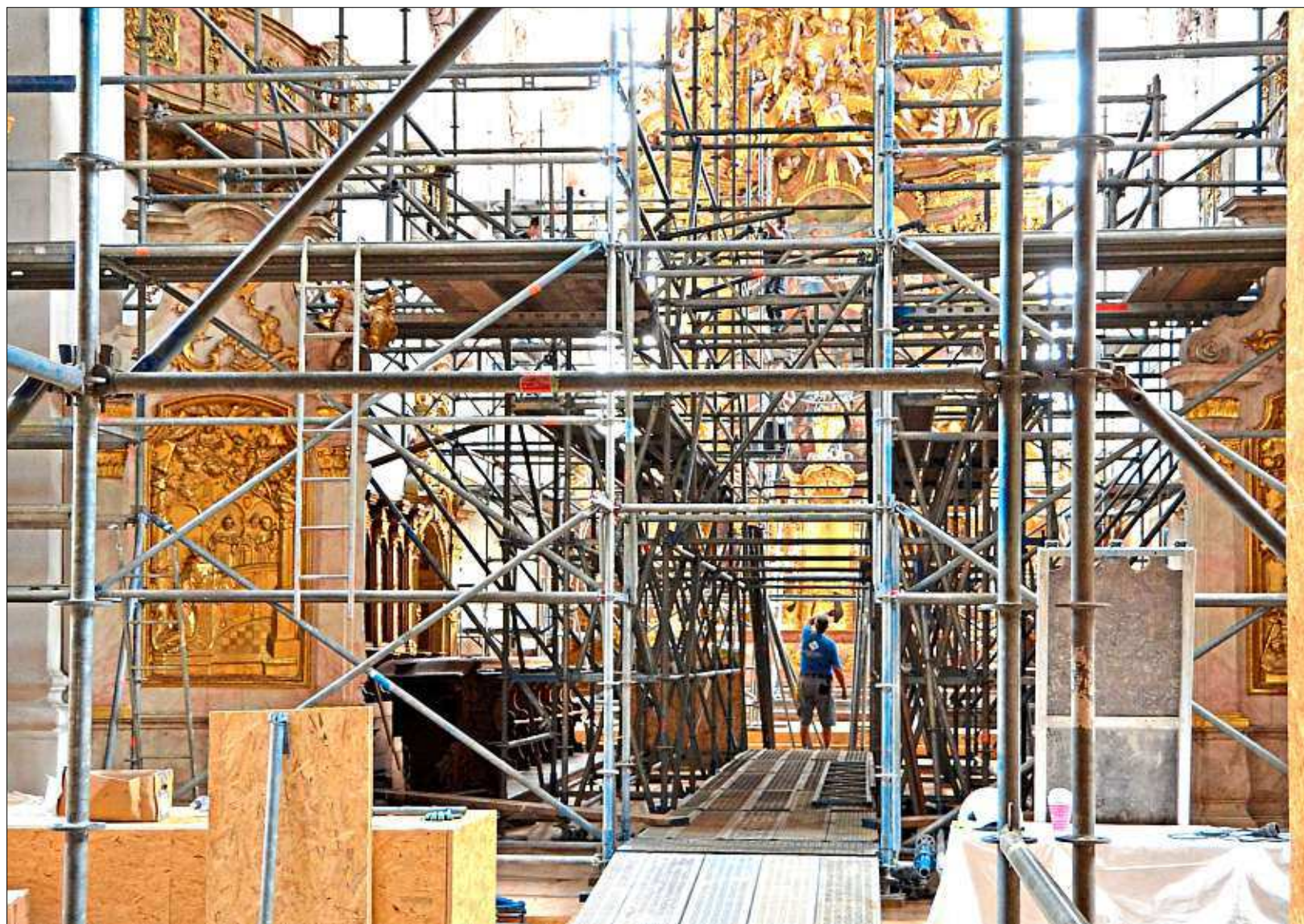
Der Aufbau des Raumgerüsts hat begonnen: Es dient als Arbeitsbühne für die späteren Restaurierungsarbeiten an Stuck, Putz, Fassungen und Fresken. – Foto: Felix Viemann/Staatliches Bauamt
