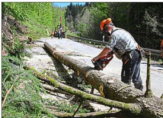
Mit Motorsägen zerkleinern die Arbeiter der Fachfirma die Baumstämme auf eine Länge von vier bis fünf Metern.
