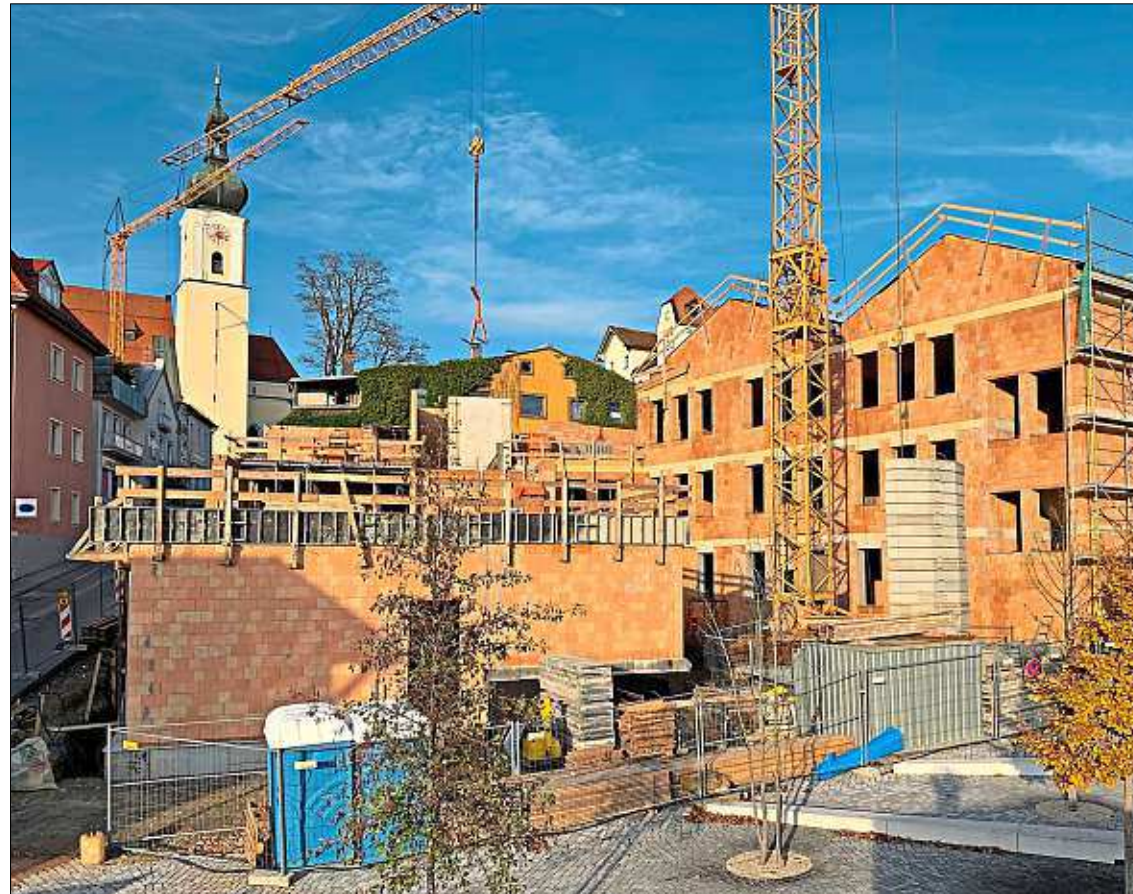
Südansicht der Baustelle des Finanzamt-Neubaus am Stadtberg: Die giebelständigen Gebäude (rechts im Bild) an der Hauptstraße sind im Rohbau bereits fertiggestellt, auch an der Scharrerstraße steht bereits die erste Geschossebene. – Foto: gjs Architekten
