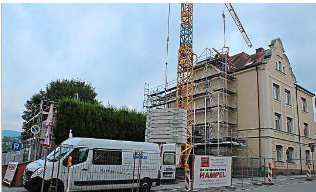
Der Erweiterungsbau des Viechtacher Finanzamtes bekommt ein neues Dach, im Altbau wird der Brandschutz verbessert. Endgültig abgeschlossen sein wird die Baumaßnahme nach Angaben von Leitendem Baudirektor Norbert Sterl, dem Bereichsleiter Hochbau des Staatlichen Bauamts Passau, erst im Herbst 2020. – Foto: Daniela Albrecht
