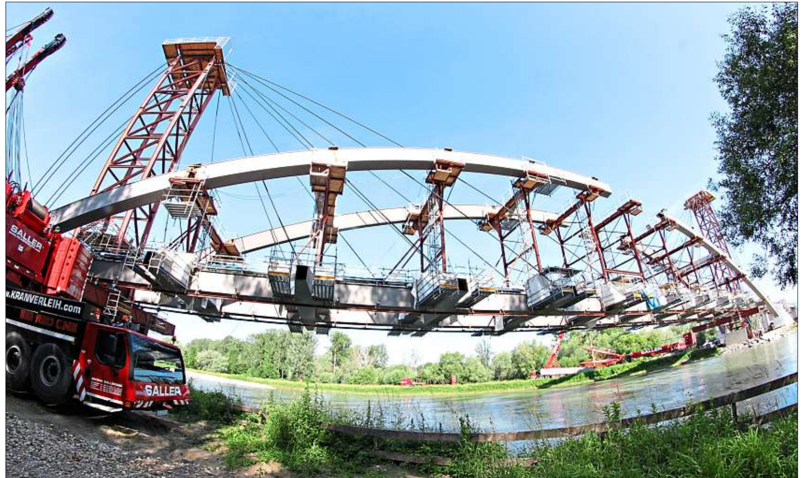
Der Brückenbogen der Plattlinger Isarbrücke ist fast fertig: Die Bogensegmente sind aufgelegt, in den nächsten drei Wochen finden Schweißarbeiten statt. – Foto: Staatliches Bauamt Passau
