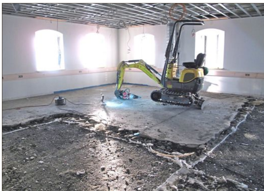
Die erst 2017 eingebauten Böden, Estriche, Installationen und auch die Fußbodenheizung (Bild) mussten herausgerissen werden. Foto: Staatliches Bauamt Passau
