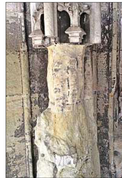
So sieht mancher Kalkstein an der Nordseite des Domchores aus. Der saure Regen setzt ihm zu.
