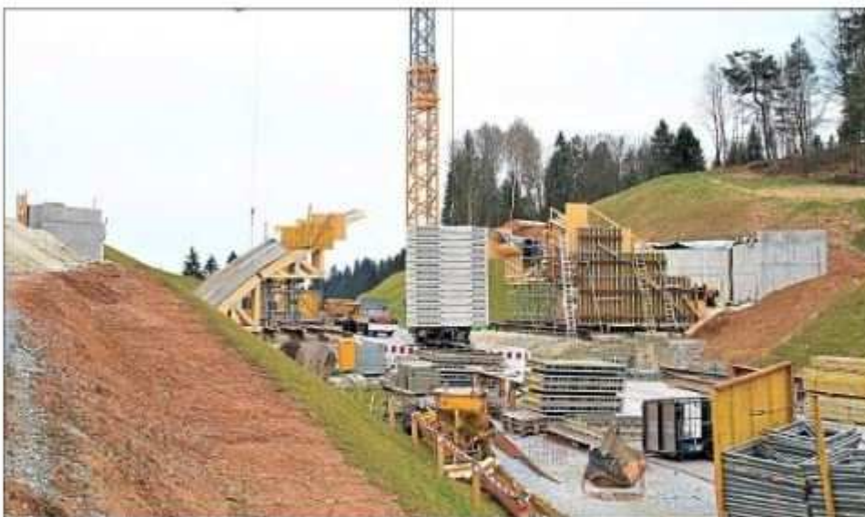
Die vier Pfeiler für den Überbau der neuen Bogenbrücke über die neue B11 bei Hochbühl wurden diese Woche betoniert. Foto: Staatliches Bauamt Passau/Süß
