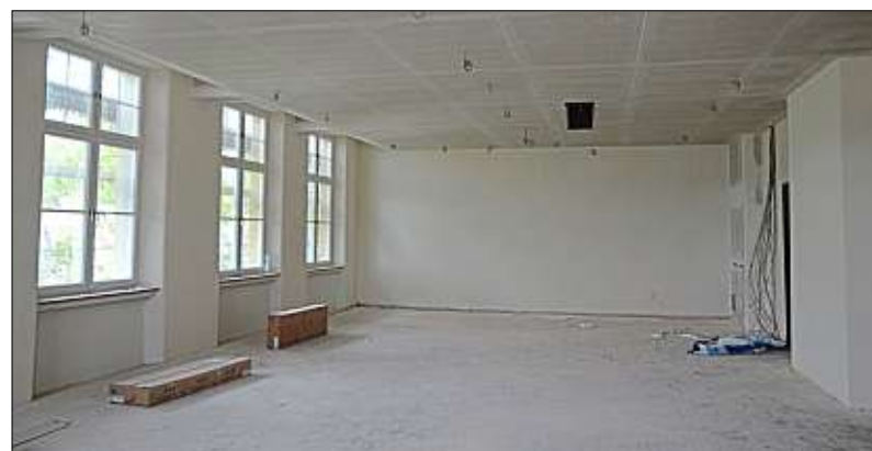
Die Kunstszene wandert komplett zurück in den Altbau und gruppiert sich um den großen Kunstsaal. Dieser ist bereits saniert. Unter der Akustik-Decke verbergen sich die zusätzlichen Stahlträger und alle Kabel.
