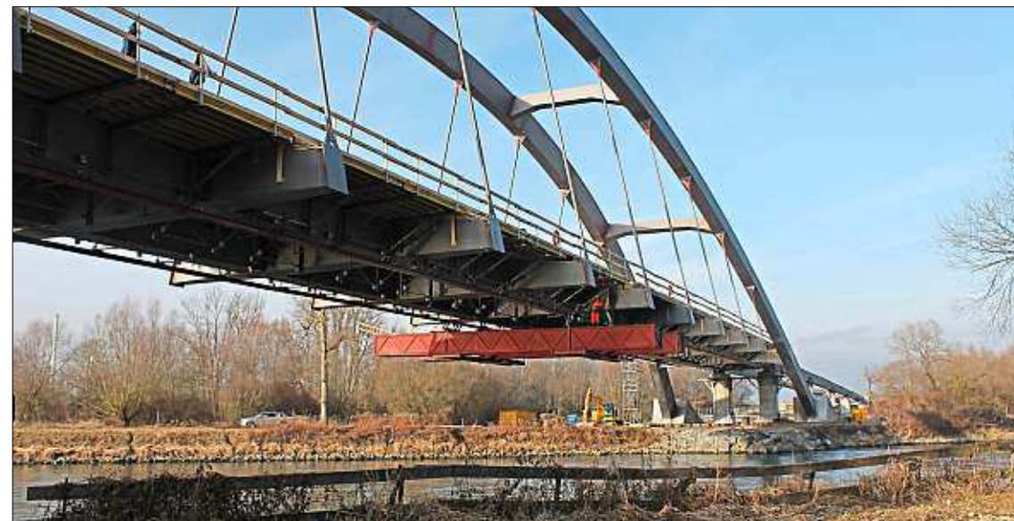
„Die Fahrbahn der Brücke wird bis in den Sommer fertiggestellt“ , sagt Robert Wufka, Leitender Baudirektor und Chef des staatlichen Bauamts Passau. – Fotos: Häusler
