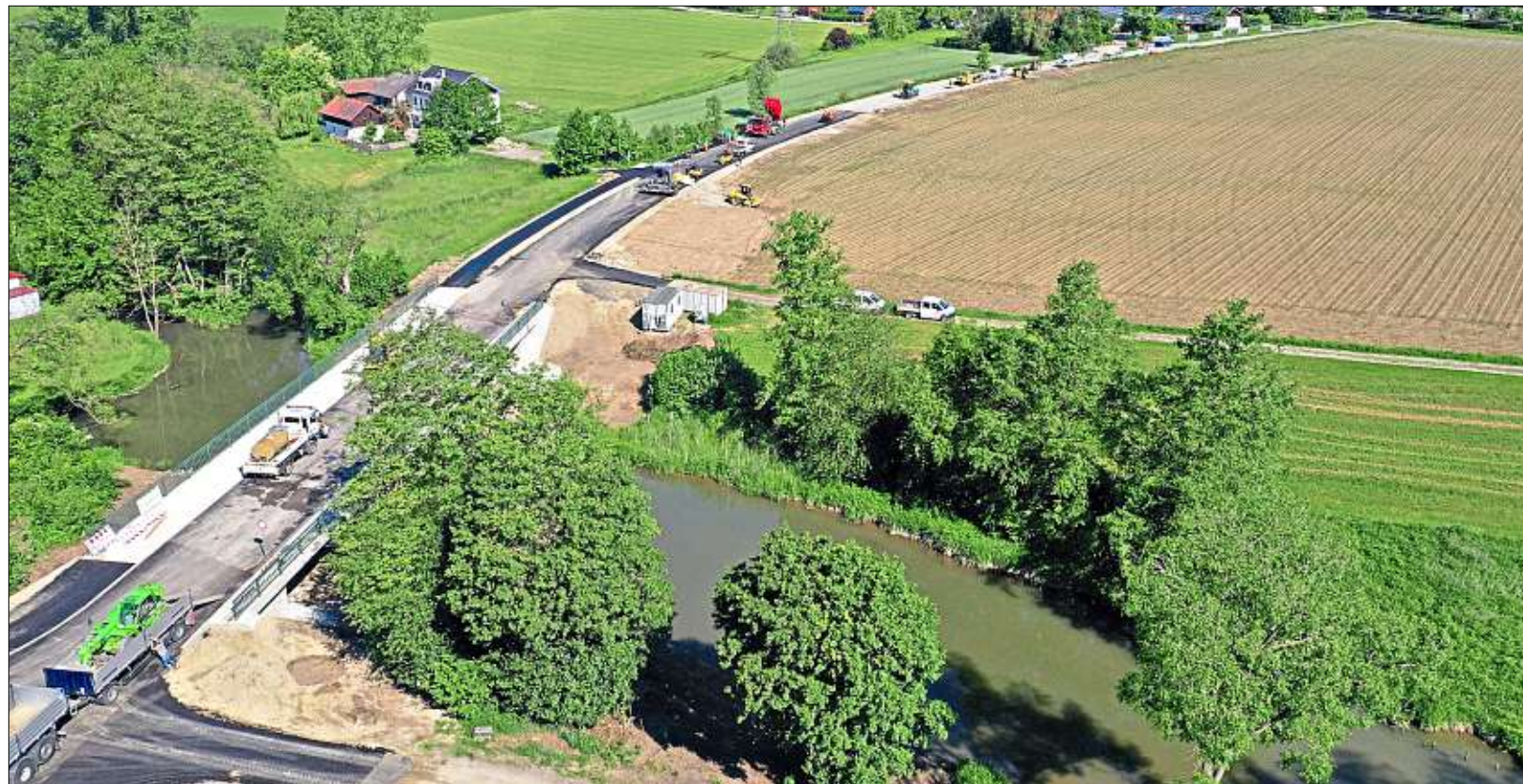
Die Verbindungsbrücke zwischen Sattlern und Mariakirchen wurde erneuert. Kostenpunkt: 1,8 Millionen Euro – Foto: Archiv Staatliches Bauamt
