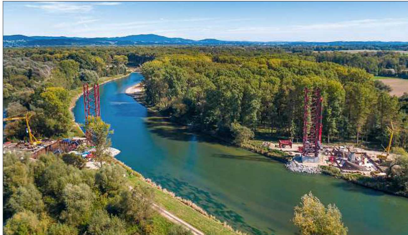
Die Baustelle aus der Luft: Gut zu sehen sind auf beiden Seiten der Isar die 41 Meter hohen roten Pylonen, die benötigt werden, um weitere Bestandteile der Brücke einheben zu können. – Foto: Staatliches Bauamt
