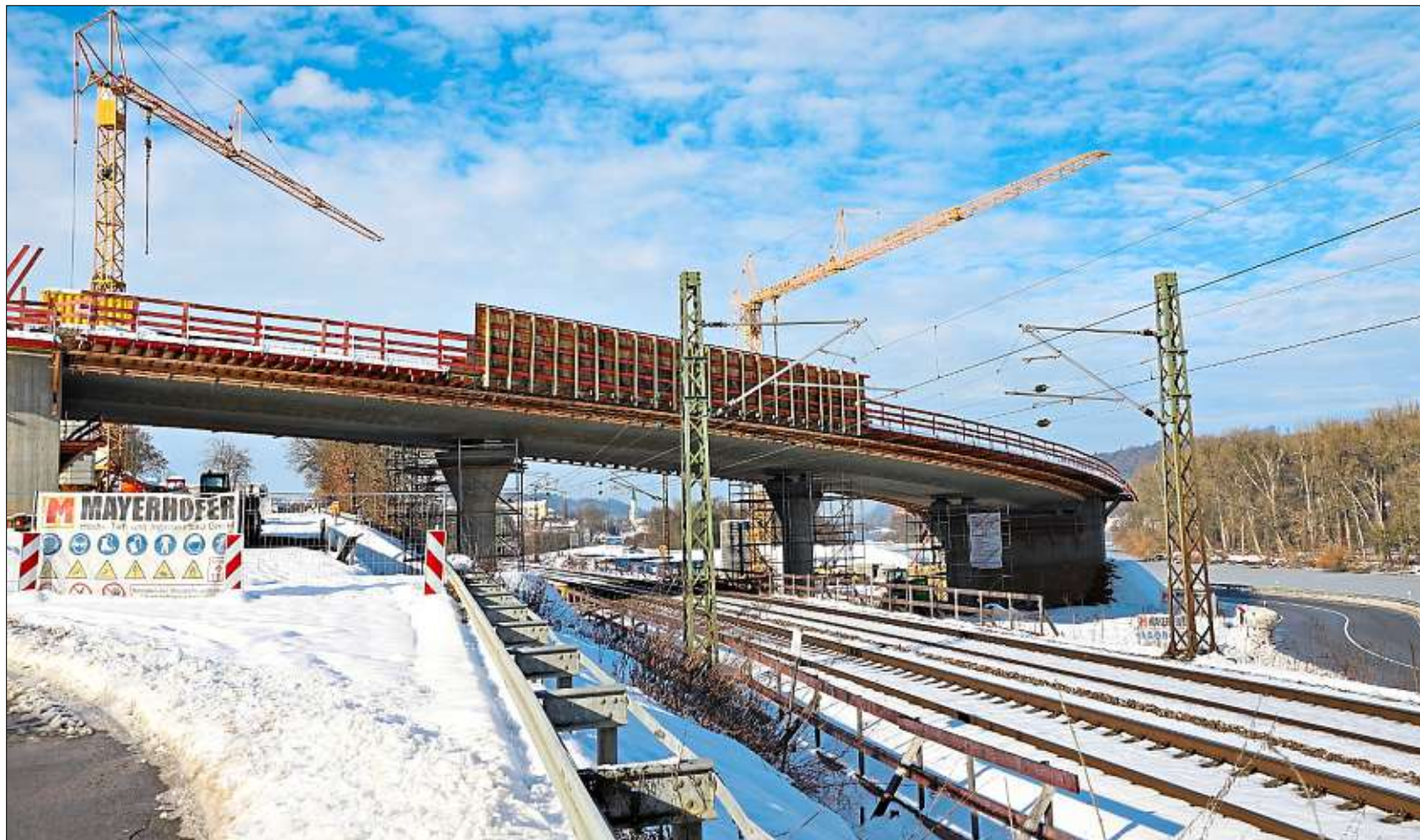
Im Moment ist Winterpause auf der Ortsumfahrung Vilshofen: Die Absenkung des Überbaus an der Brücke über die B 8 und die Bahnstrecke konnte im vergangenen Jahr noch abgeschlossen werden. – Fotos: Staatliches Bauamt
