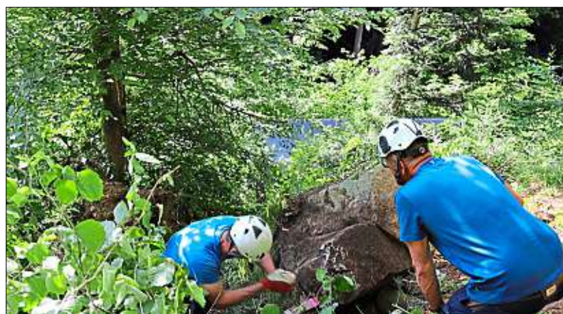
Mehr Sicherheit: Große Felsbrocken wurden von einem Hang an der Staatsstraße 2127 bei WIndorf geräumt.
